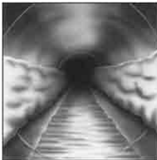
Påbyggnad av fett i plaströr. Grad 2.
