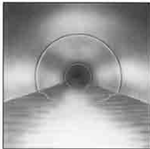
Svacka eller upphöjningar på plasttrör. Grad 2 eller grad 3 beroende på övriga omständigheter
