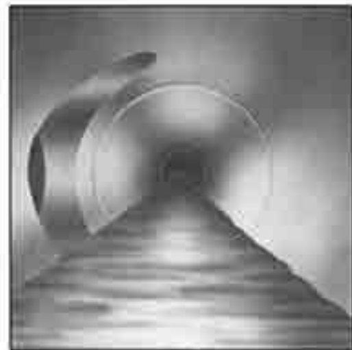
Anslutning av grenrör i en del av ledning med svacka. Plaströr Grad 2.
