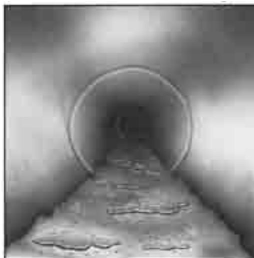
Flytspackel i gjutjärnsrör. Grad 3.
