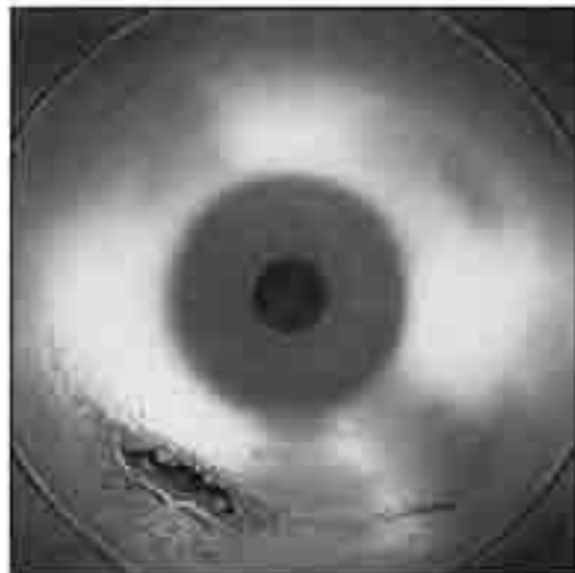
Ytskada, korrosion, i gjutjärn. Grad 3. Placering klockan 06-08
